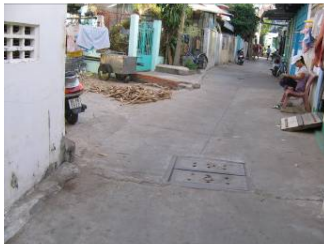
Ảnh 3: Cống công cộng cung cấp bởi Dự án Ngân hàng Thế giới – Phường An Cư
