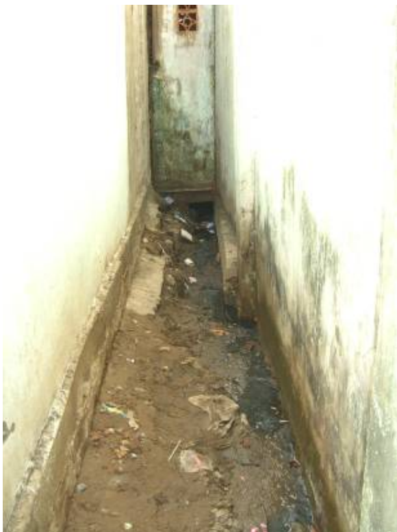
Ảnh 9: Mương thoát nước thải hộ gia đình – Phường 9
