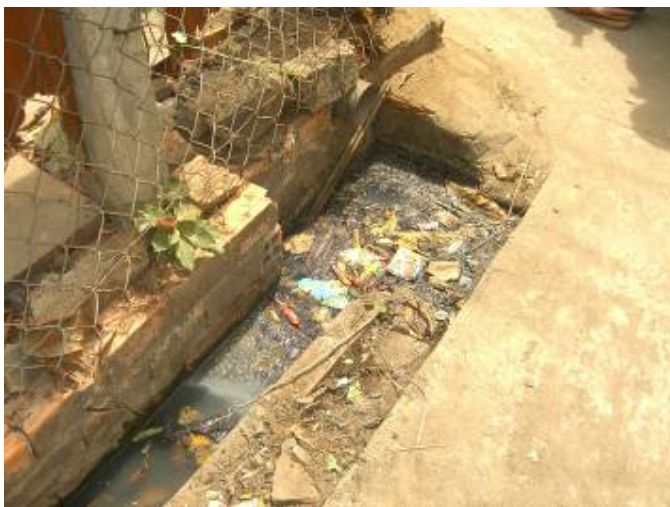
Ảnh 5: Cống thoát nước công cộng – Phường 7
