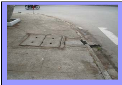
Cống rãnh kín ngoài đường chính
